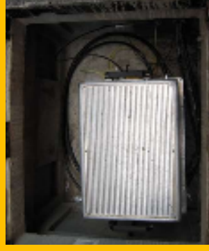
ONU-Cab 48 porte installato in contenitore stagno in pozzetto
